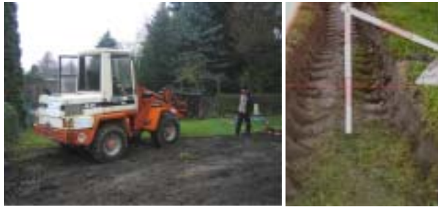
Bodenverdichtung auf Baustellen. – Foto 5, 6: 17 cm starke Bodenkompression durch einen kleinen Radlader.
