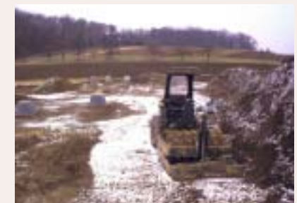
Boden wird abgeschoben, obwohl er für die Regenwasserentwässerung im zukünftigen Wohngebiet wertvoll wäre.
